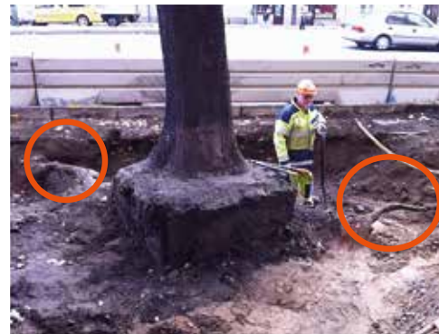
Pipelinerötter som blottagts vid schakt.
