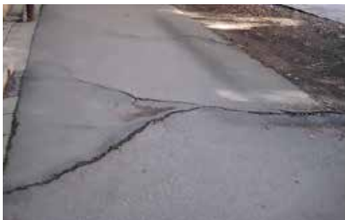
Skador på beläggning orsakade av rötter.
