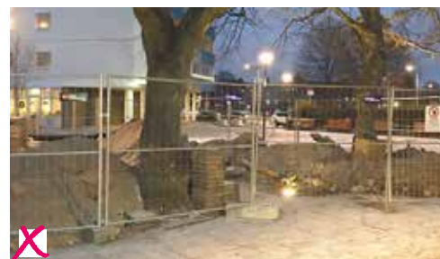
Ingen avspärning: upplag och entreprenadstaket inom rotzonen.
