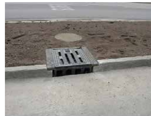
Brunnsbeteckning med sidointag.
